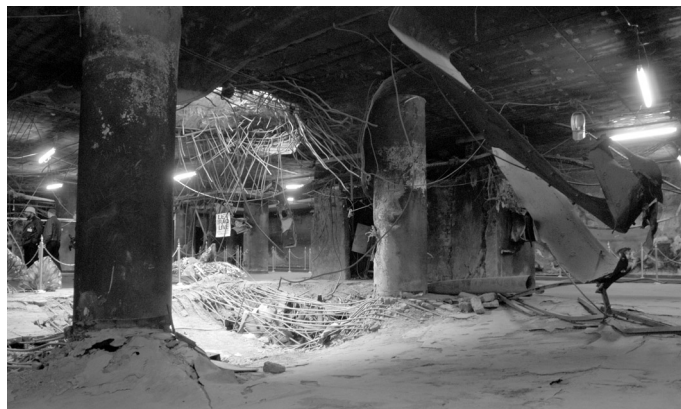
Amariya-Bunker, Bagdad: Am 16.02.1991 zerstörte eine bunkerbrechende Bombe zunächst die Decke des Bunkers, dann folgte eine lasergesteuerte Brandbombe. 408 Zivilisten starben.
